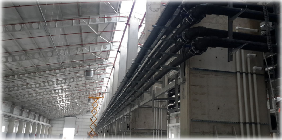
Mutlu Akü, Proses Borulama Sistemi
