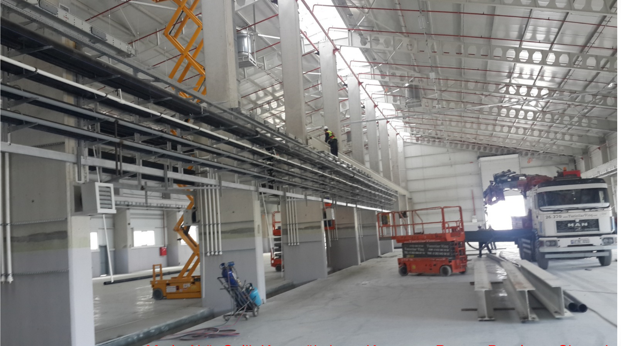
Mutlu Akü, Çelik Konstrüksiyon, Kreyin ve Proses Borulama Sistemi
